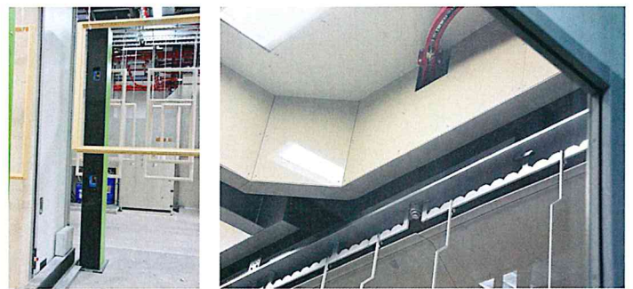
Links ist der Scanner zu sehen, rechts die spezielle Verkleidung der Hängebahnen im Lackierraum.
